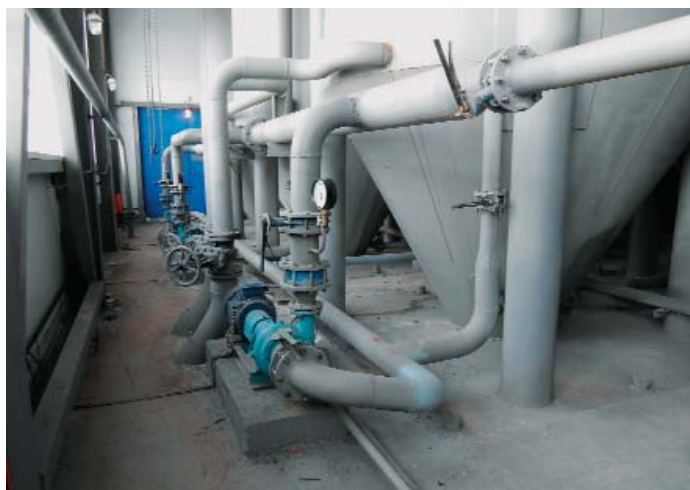
Нагнетательные линии циркуляционных электронасосных агрегатов
